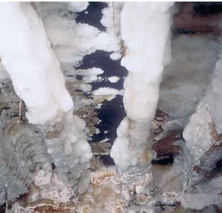
Der Hausschwamm an einer Kellerdecke in Liverpool mit wattigem Myzel und Fruchtkörpern
